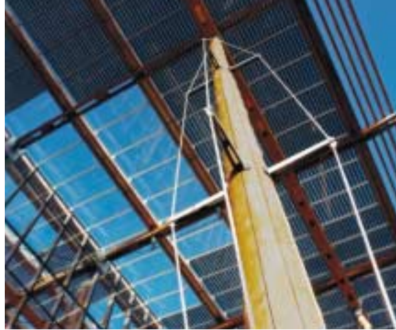
Fotovoltaikanlage auf der Fortbildungsakademie Mont-Cenis in Herne
